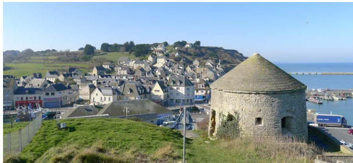
Extension urbaine sur les coteaux, la tour Vauban menacée par l'érosion de la falaise, Arromanches.
