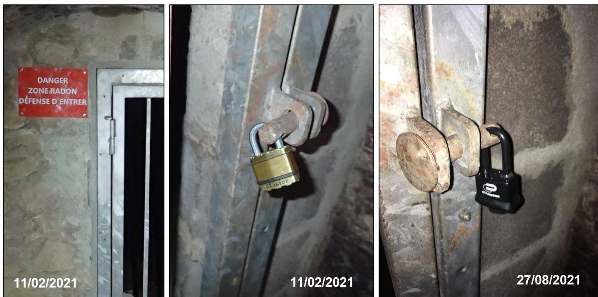
Figure 16 : Panneau et cadenas du portillon à l'entrée du TB de l'Orne.
