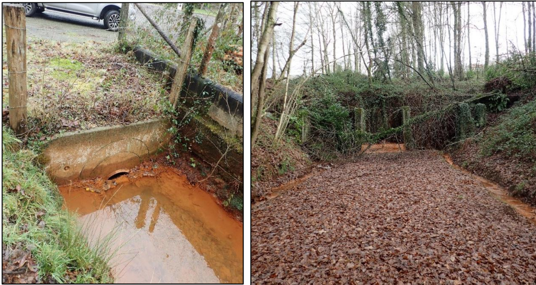
Figure 17 : Grille obstruée sur fossé nord vers rue de la Piscine (gauche) et arbre déraciné (droite).
