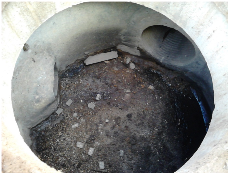
Photographie 9 : Regard n°11 léger dépôt de gravats
