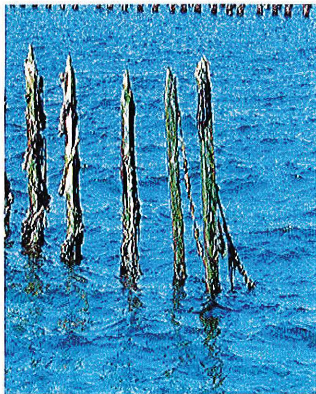
Etat des pieux après prédation
