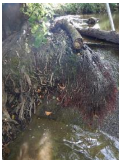
Figure 17: Vue de la voie de reptation en rive droite de l'ouvrage des Pierres Ferrées (source : MN'EAU)
