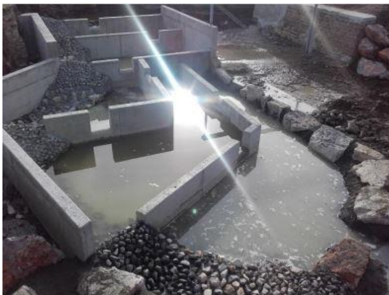
Figure 24: Exemple de pré barrage à échancrure rectangulaire en cours de réalisation (source : MN'EAU)
