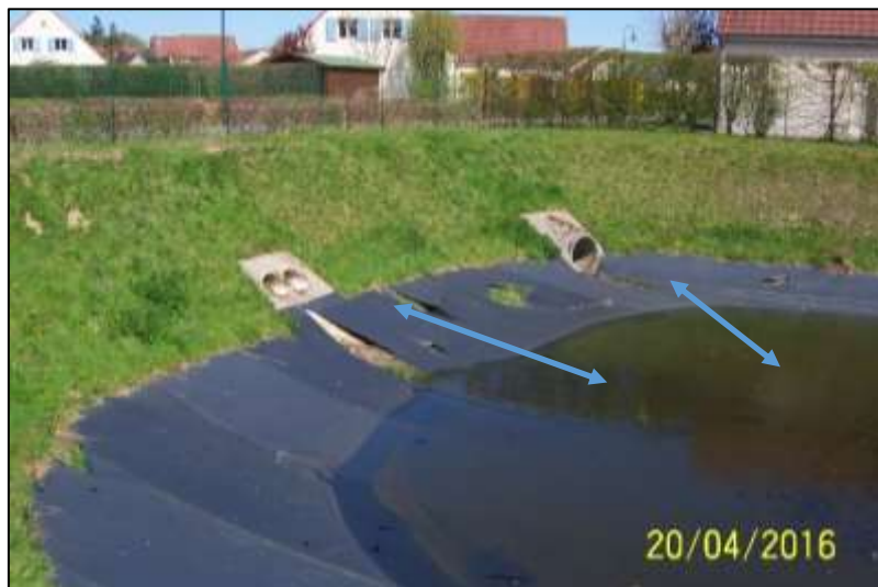
Bassin BR178 : arrivée et sortie d'eau
