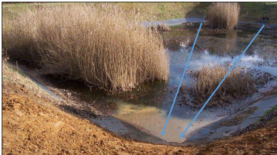
BR177 : trajet de l'eau de l'arrivée vers la sortie du bassin, entraînant la végétation vers le débit de fuite (D200) et risquant de boucher la vidange
