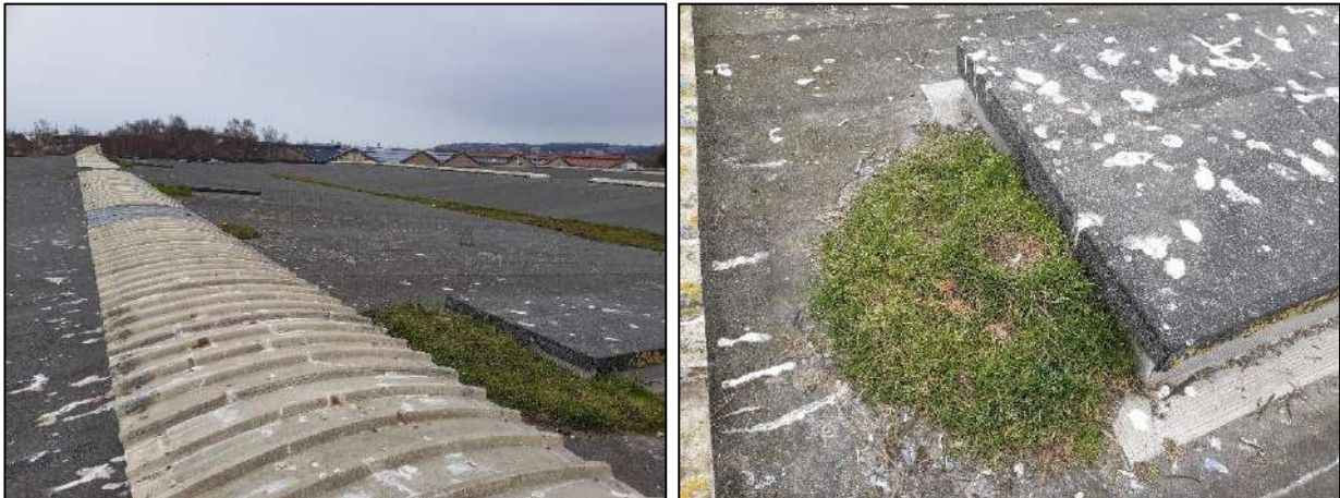
Figure 17 : Configuration des toitures et localisation des amas de végétation sur les toitures des bâtiments
