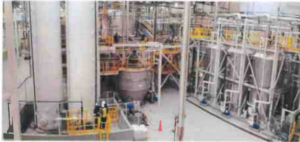
Ligne de désulfurisation
