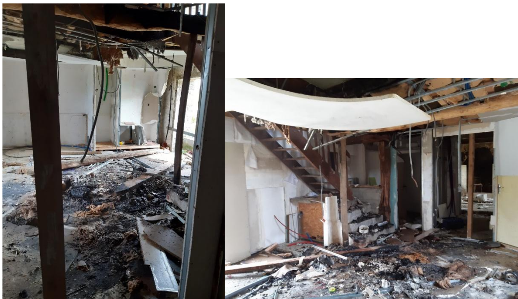
Photo 6 : Photographies de la partie d'habitation du bâtiment 17 ayant fait l'objet d'un début d'incendie au début 2023 @ Mickaël Lebéhot, 2023
