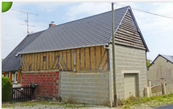
Bâtiment en pans de bois et briques ayant été successivement et de façon peu équilibrée, transformé avec des parpaings ; vers Saint-Evrout-de-Montfort sur la RD 721.
