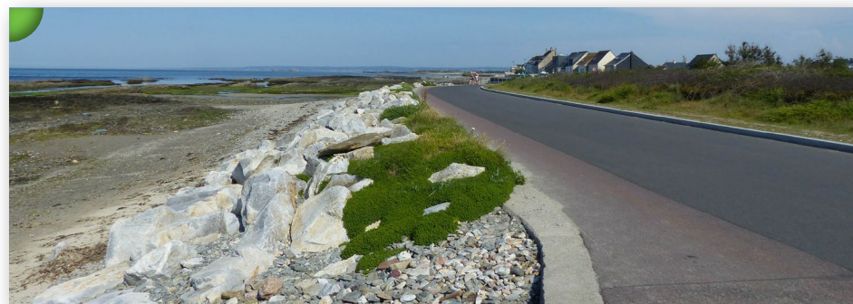
Lieu-dit Le Pré de la Mer à Urville-Nacqueville : front de mer bâti qui nécessite le renforcement de son trait de côte par un empiérement, afin de lutter contre l'érosion.
