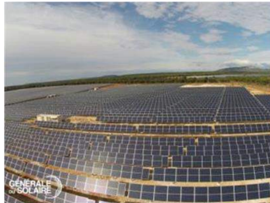
Centrale de Belvezet, Gard
