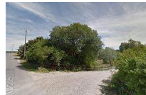
Ligne HTA à l'entrée du site
