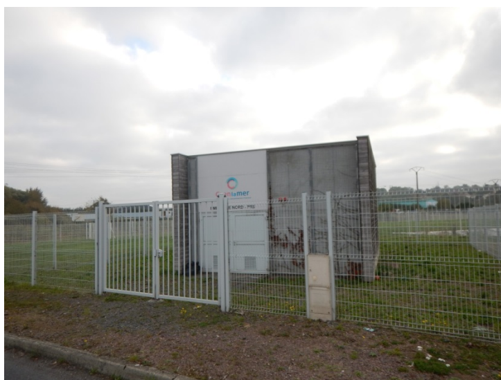
Fig. 5. Raccordement sur le poste de refoulement PR6 de l'Emissaire Nord de la Communauté Urbaine de Caen la Mer
