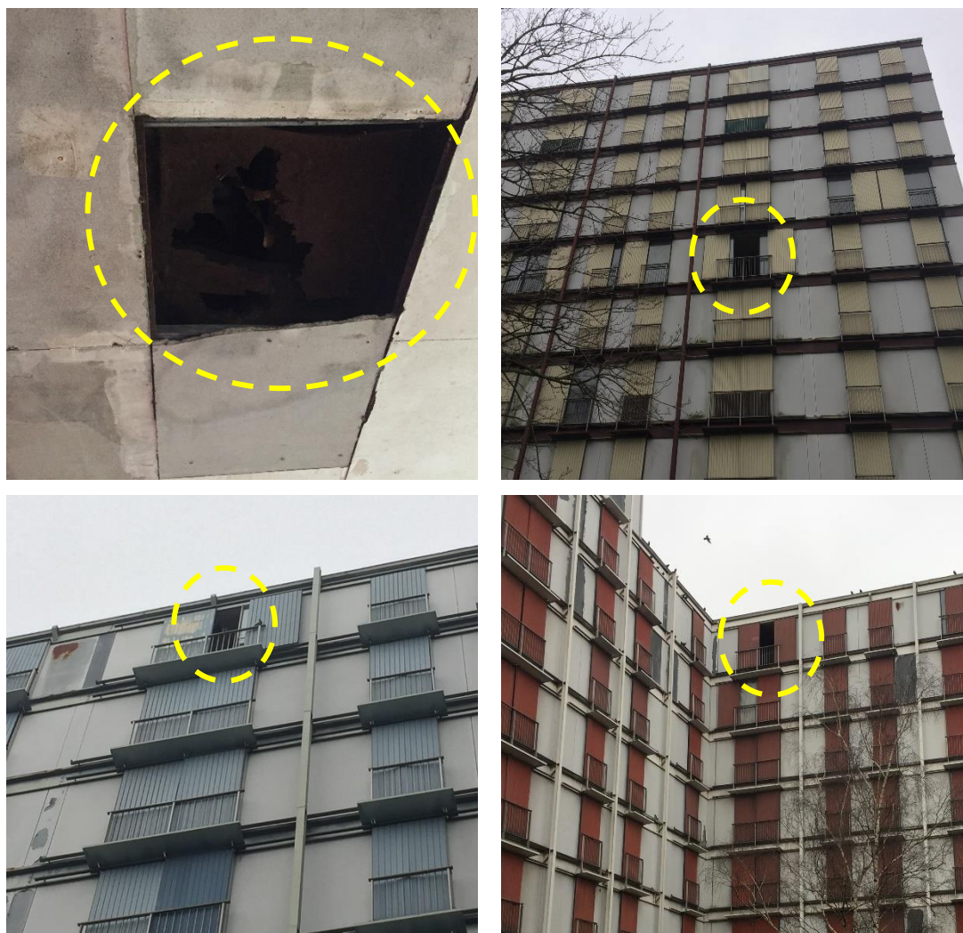
Figure 19 : Fenêtres brisées et ouvertures visibles dans le bâtiment du site
