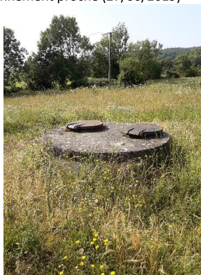
Photo 2 (P2) : Forage FE1 dans son environnement proche (27/06/2019)
