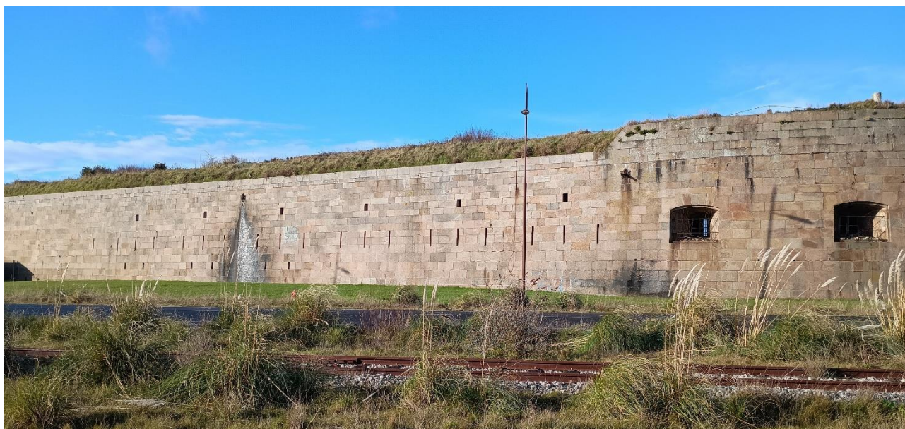
FIGURE 11 : FORT CONTENANT DES ENTREES PAR FENETRES CASSEES, POTENTIEL SITE DE GITE POUR CHIROPTERES
