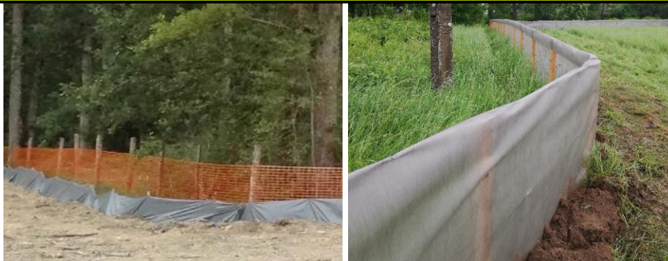
PHOTOGRAPHIE 31 : EXEMPLES DE CLOTURE ANTI-INTRUSION
