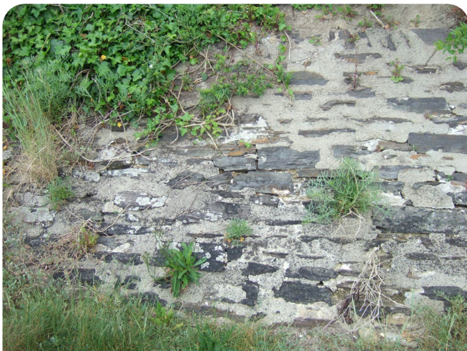
Maçonnerie (perré) dégradée par la présence de végétation
