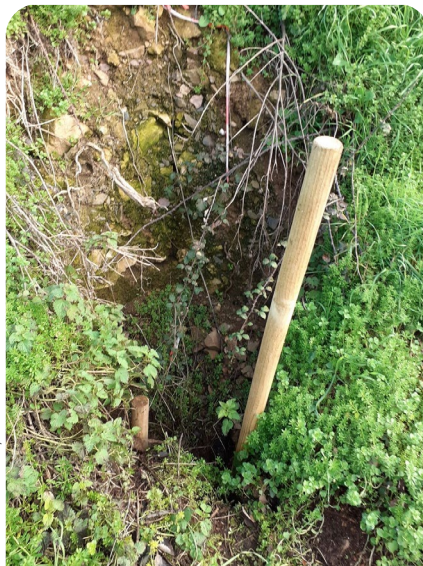
Fontis causé par le dépérissement d'une souche
