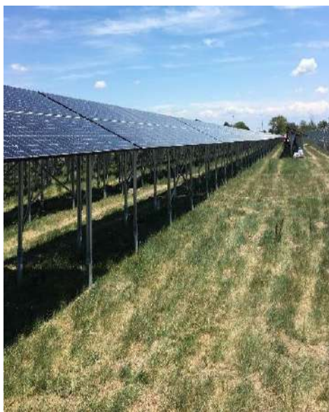
Figure 24 : Exemple de surélévation des panneaux sur la centrale au sol photovoltaïque de Salins-de-Giraud (13) avec un risque de submersion marine de 2 à 3 m / URBASOLAR
