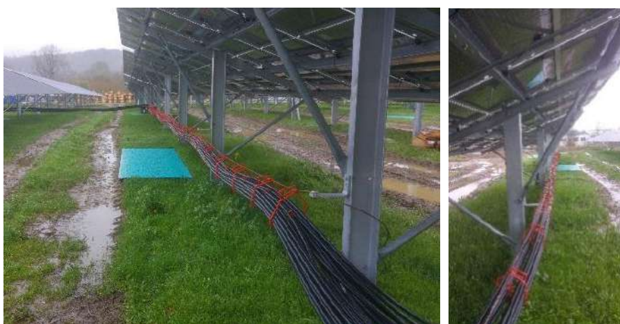
Figure 21 : Exemple de câbles aériens sous les modules
