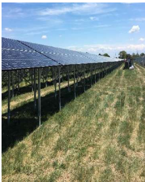
Figure 28 : Exemple de surélévation des panneaux sur la centrale au sol photovoltaïque de Salins-de-Giraud (13) avec un risque de submersion marine de 2 à 3 m / URBASOLAR
