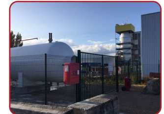
Cuve GPL à proximité immédiate d'une activité Seveso
