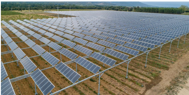
Première centrale agrivoltaïque au monde. Démonstrateur sur vignes dans les Pyrénées-Orientales.
