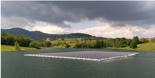
Centrale photovoltaïque flottante du Lac de la Madone (Rhône)
