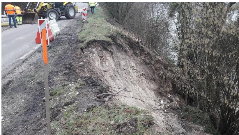
Effondrement (janvier 2018) menaçant la RD 982
