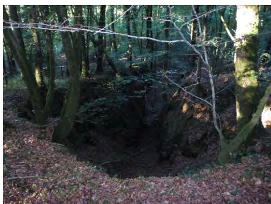
Photo 13 : Fontis Galerie de Doumont
