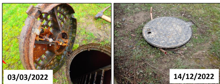
Figure 20 : Effractions sur le puits d'accès D27.
