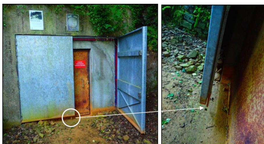
Figure 19 : Tringle de verrouillage sciée sur la porte d'accès au flanc sud.
