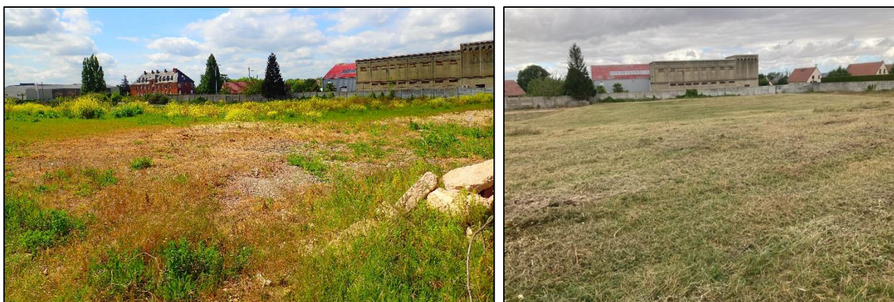
Figure 8 : Broyage des végétaux en zone 10 avant travaux (gauche) et après travaux (droite).
