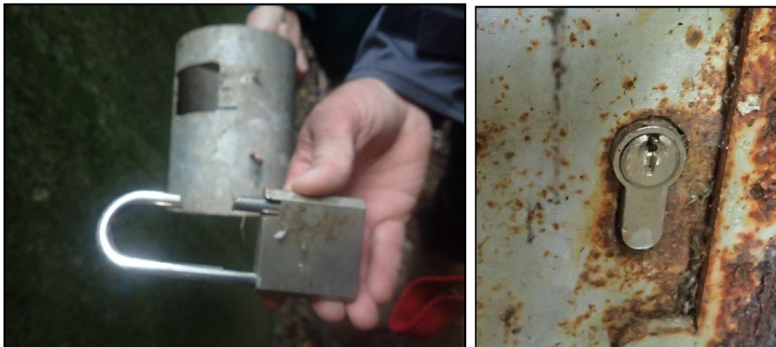
Illustration 10 : Flanc nord, tentative d'effraction constatée en septembre 2020.
