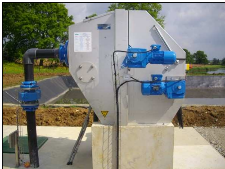
Exemple de tamis rotatif avec débitmètre électromagnétique sur la colonne montante
