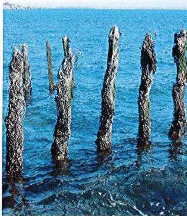
Etat des pieux après prédation (Autre exemple)
