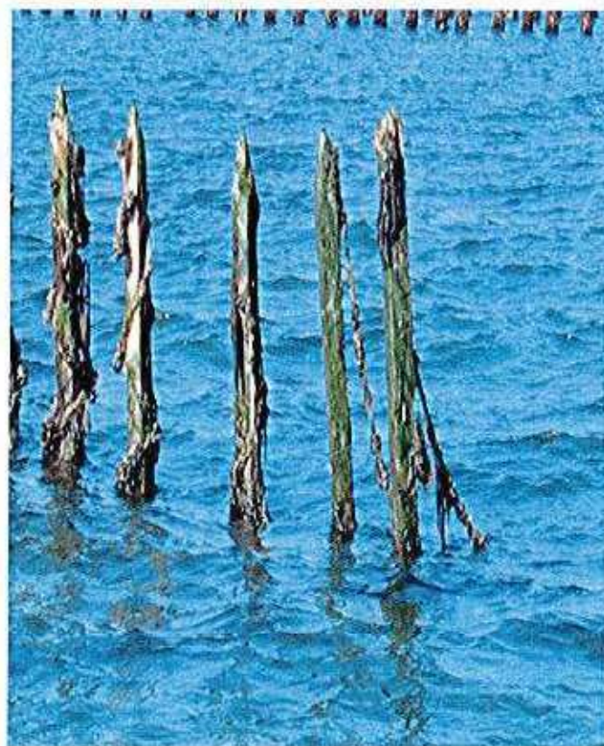
Etat des pieux après prédation
