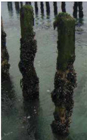
Figure 12 : Pieu après prédation
