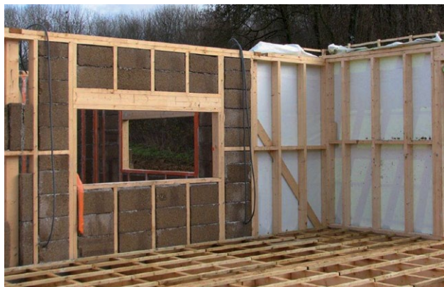
Murs en briques de chanvre et projection de béton de chanvre ©C&B
