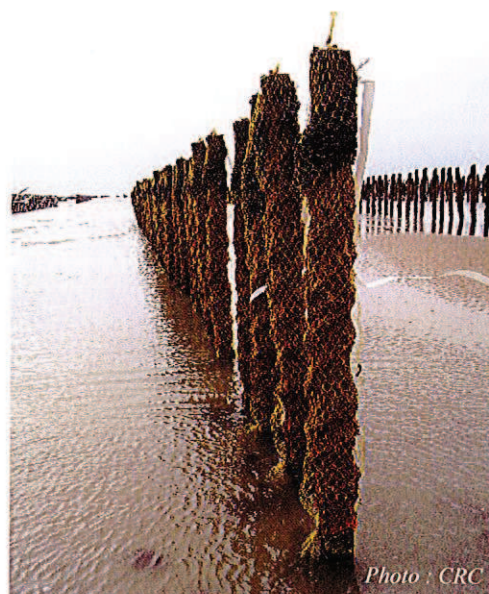
Figure 28 : Dégâts causés par des eiders
