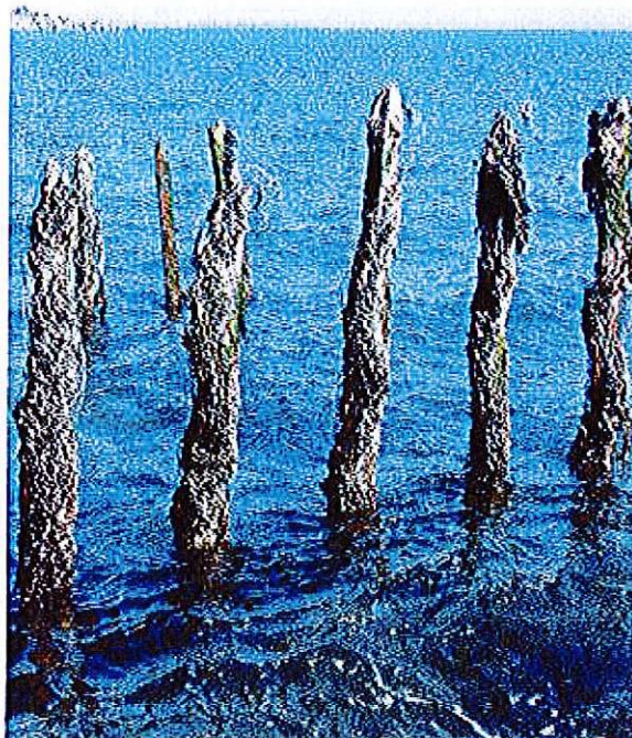
Etat des pieux après prédation (Autre exemple)
