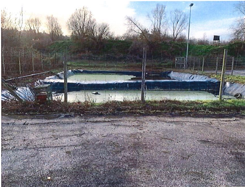
Photo n°3 : vue des bassins de récupération des eaux de la plateforme
