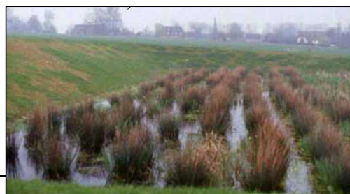
Fig. 4.5. : Exemple de bassins plantés
