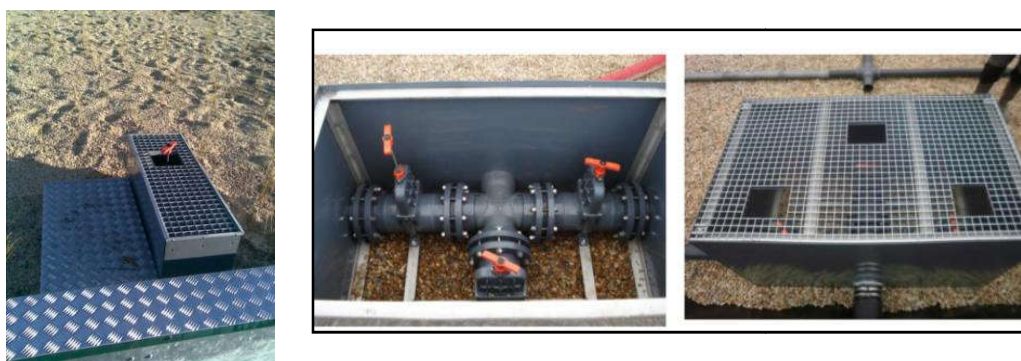
Fig. 4.3. Vannes guillotines en entrée du casier
