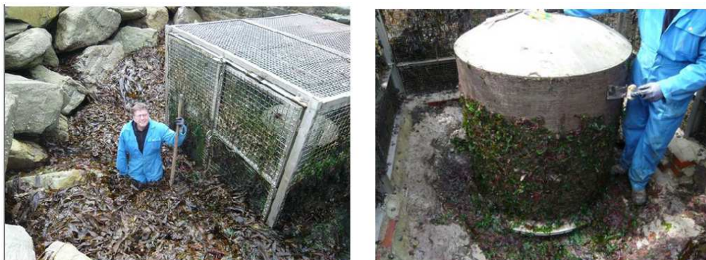
Figure 6 : Photo de l'envahissement de la prise d'eau par les algues et du nettoyage de la crépine
