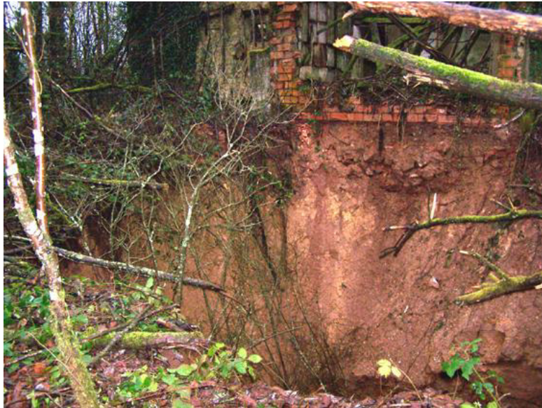
Photo 1 : effondrement de janvier 2008 (GEODERIS)
