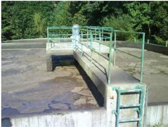
Bassin d'aération avec turbine
