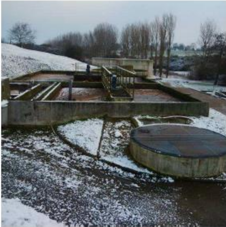
Poste de relèvement et bassin d'aération équipé de turbines
