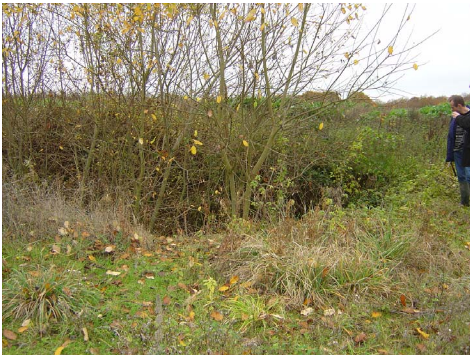
Photographie 6 – Effondrement d'une cheminée Bully (flanc sud)
