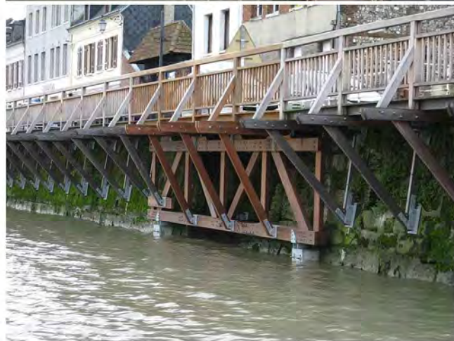
Quillebeuf-sur-Seine Trottoir bois de 400m en encorbellement suspendu aux quais de Seine, réalisé par Valbois, architecte atelier NIS
