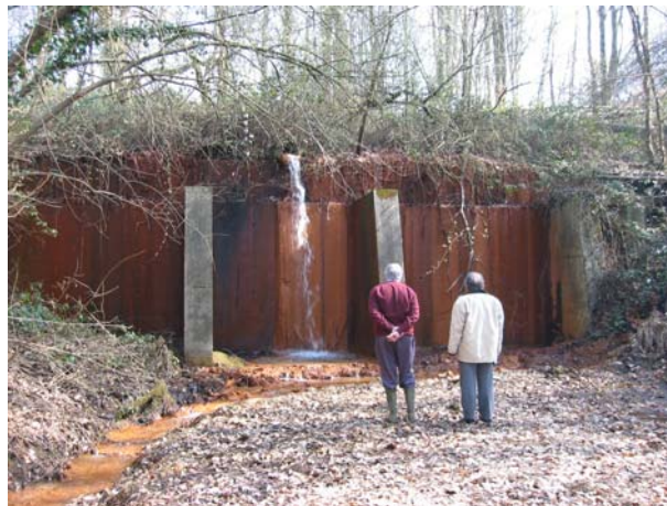
Photographie 1 : barrage d'obturation du TB 220
